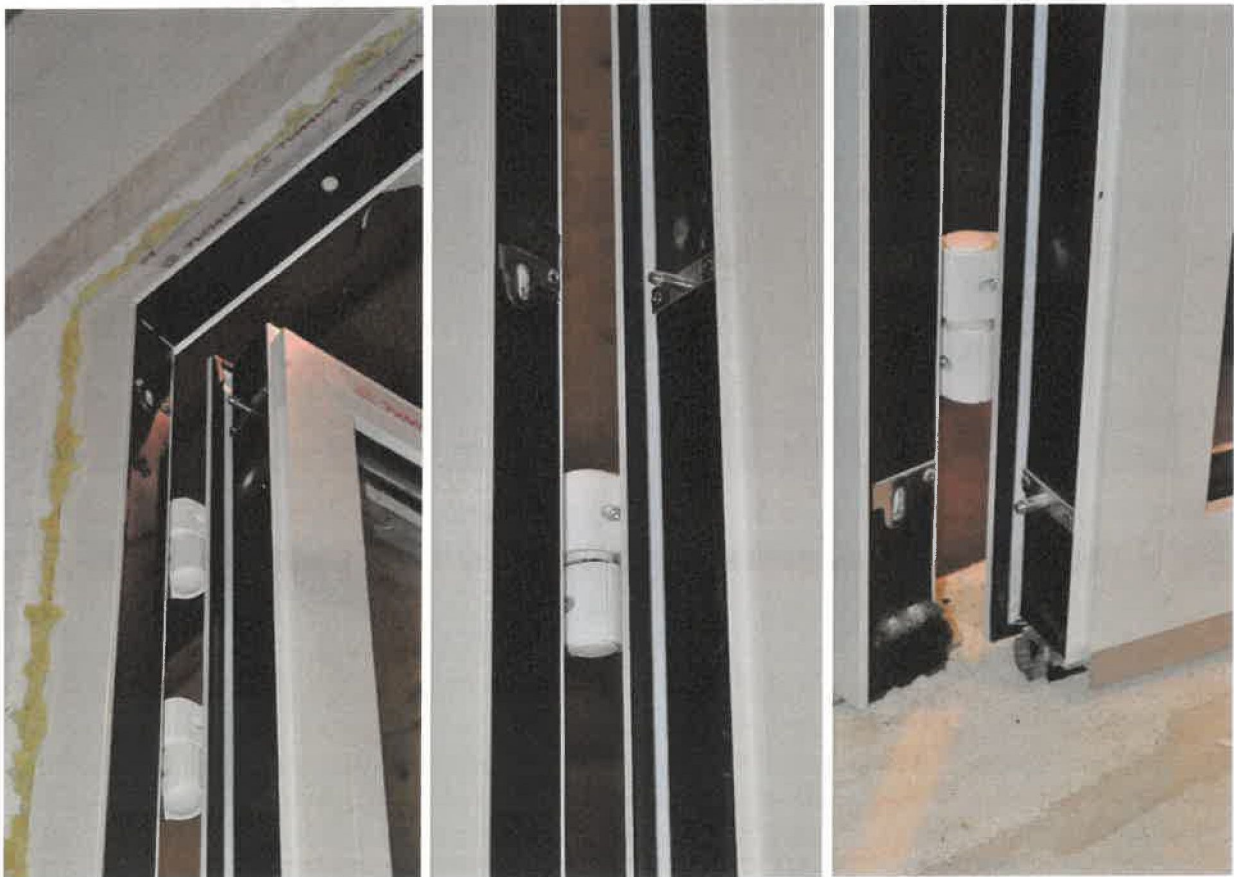
Foto .4 Oberflächenansicht des Prüfkörpers Nr. 2 vor der Prüfung - Details
